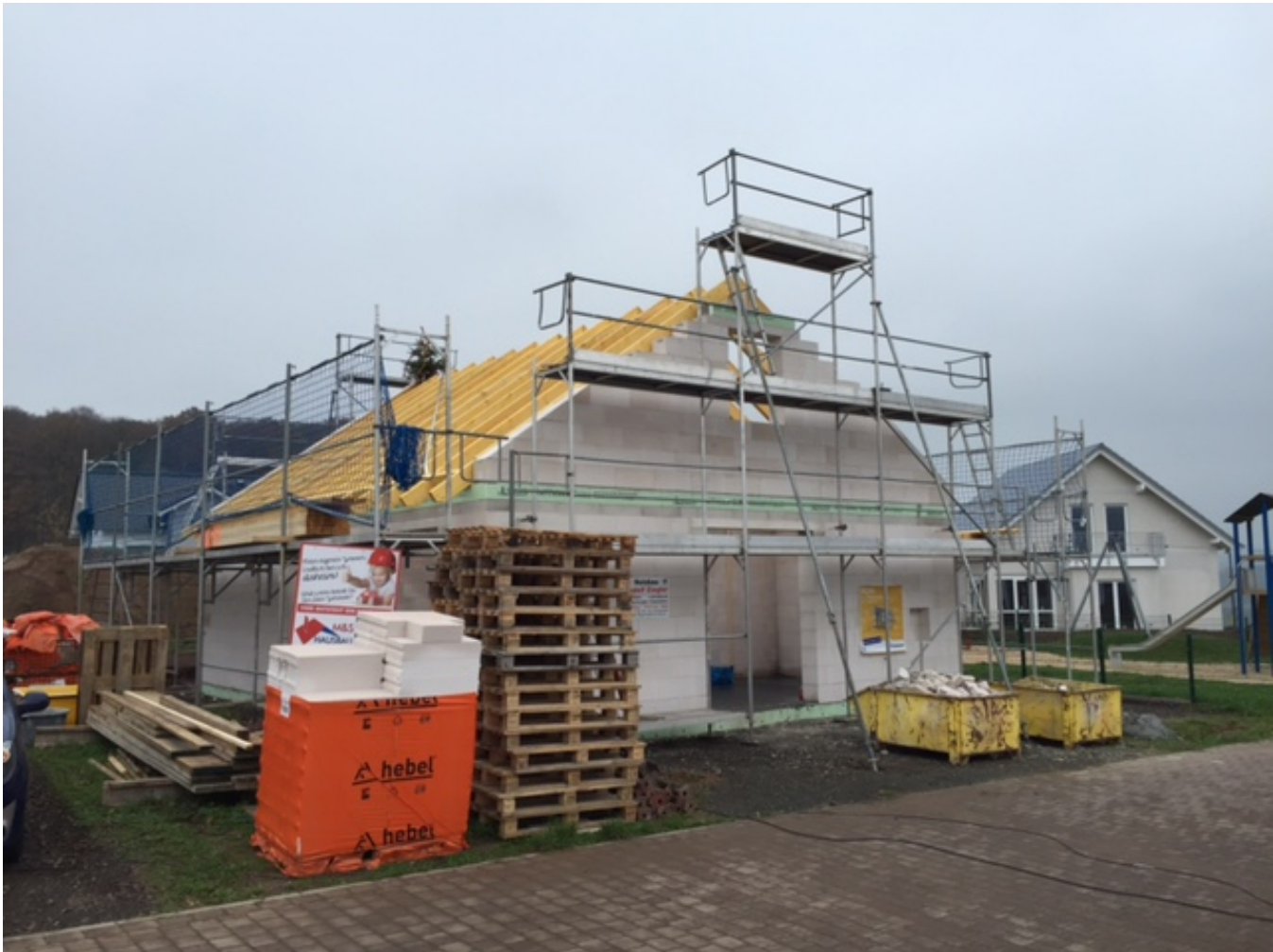
So, Richtfest ist geschafft – Dach drauf, Fenster rein - der Winter kann kommen
